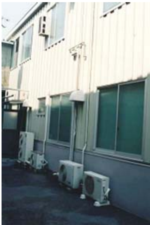
エアコン室外機
